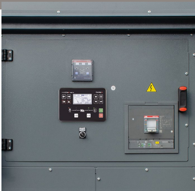
> Cuadro automático con unidad de control ComAp AMF8
